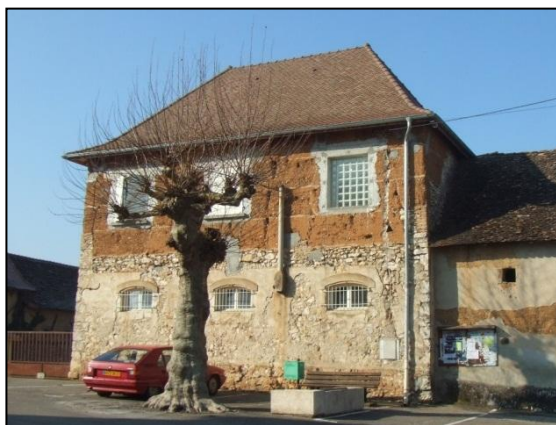
Toiture écaillé, mur en pisé
